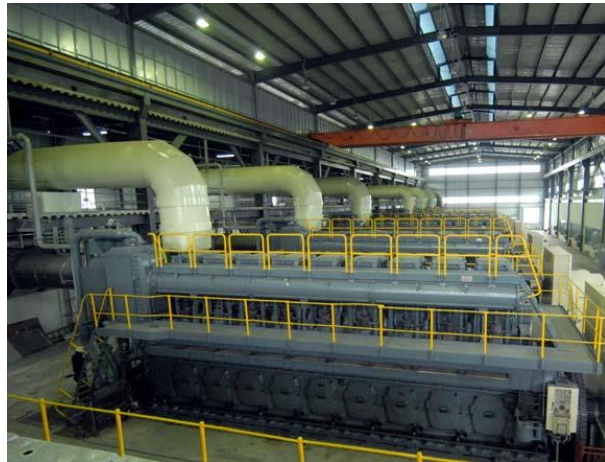
107,3 MW PLTD/ MFO PP Belawan, Sumatera Utara/North Sumatera (sudah tidak beroperasi)
